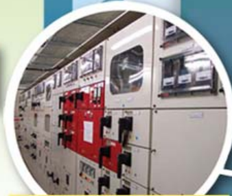
電力裝置 Electrical installation
